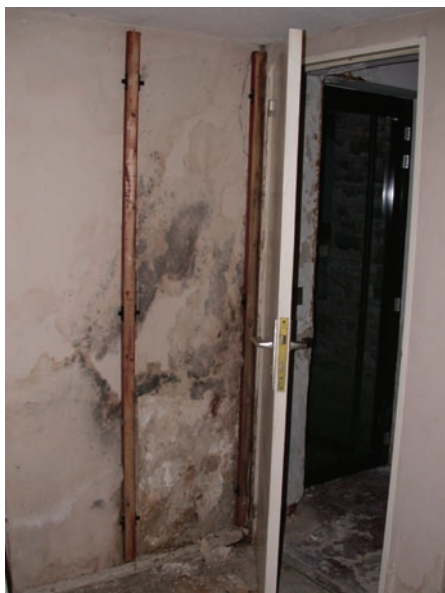
Fig. 2 Humidité et moisissures au niveau des finitions.
