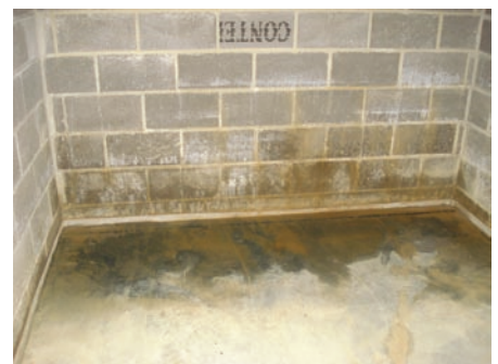
Fig. 3 Humidité au bas du mur d'une cave.
