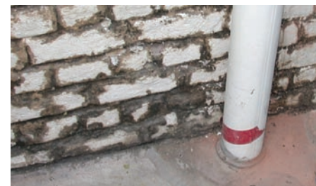
Fig. 10 Exemple d'efflorescences et de dégradation des joints.
