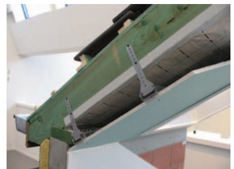
Fig. 1 Exemple de plafond partiellement désolidarisé.
