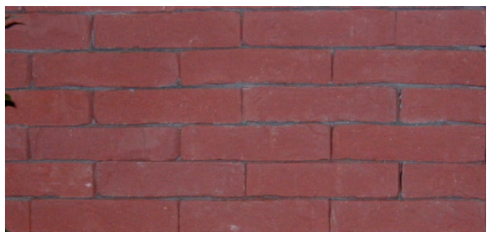
Fig. 27 Maçonnerie collée à joints minces avec un type de briques irrégulières (irréaliste de spécifier un joint d'épaisseur régulière et trop mince) (cas 4).
