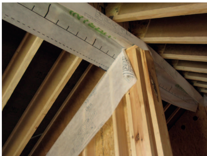
Fig. 6 Raccord entre une cloison et une faîtière. La continuité de la barrière d'étanchéité à l'air est assurée par une membrane d'attente.
