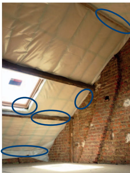
Fig. 1 Étanchéité à l'air insuffisante de la toiture dans une maison mitoyenne en raison d'un mauvais traitement des raccords
