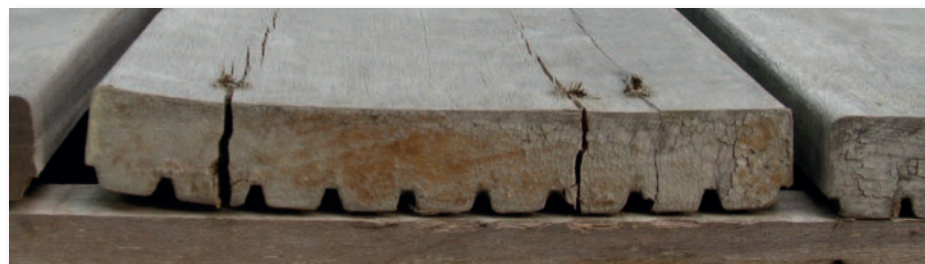
Fig. 1 Fissuration au droit des points de fixation
