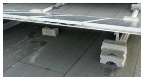
Fig. 1 Glissement de l'installation photovoltaïque
