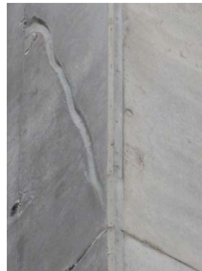
4 | Empreinte à la surface du béton dû au plissement de la nappe de coffrage
