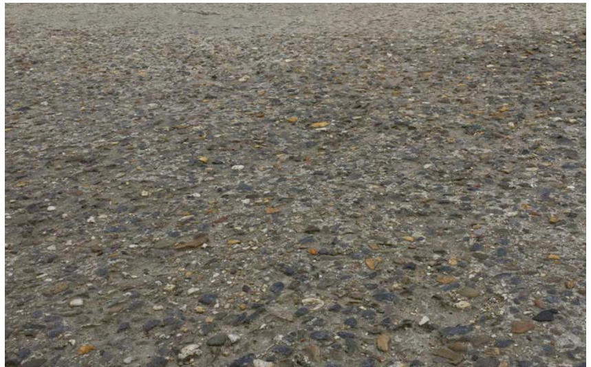
2 | Écaillage de la surface dû à l'action combinée du gel et des sels de déneigement.
