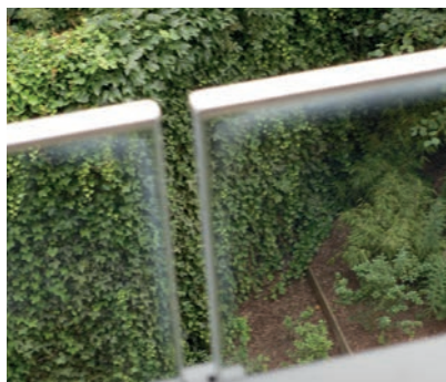
1 | Blanchiment lié au contact avec une colle incompatible (bord supérieur) et l'humidité (bords latéraux)
