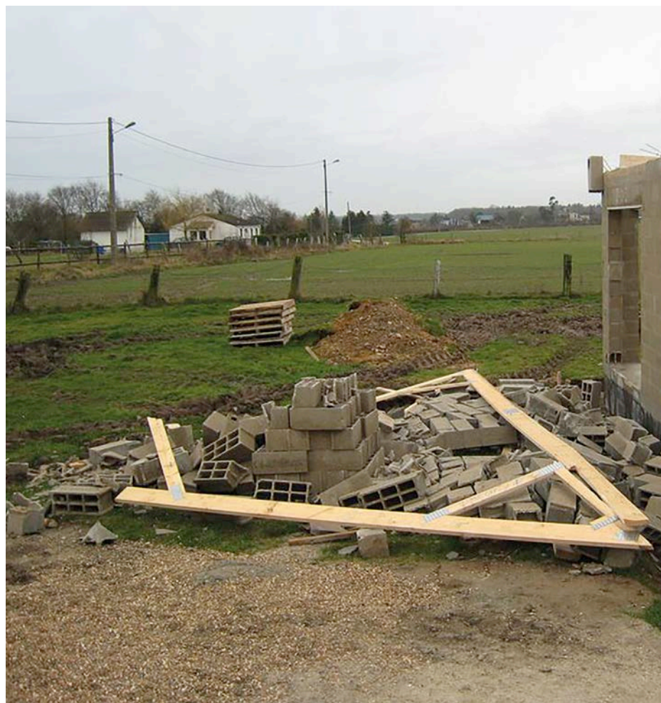
Effondrement d'un pignon maçonné à la suite de fortes sollicitations du vent
