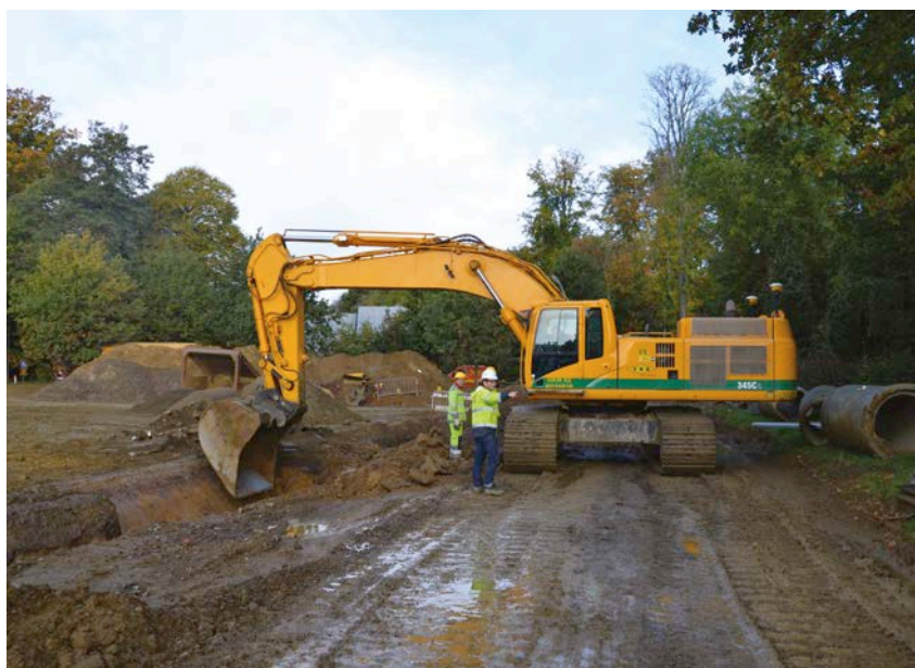
1 | Le pilotage 3D offre de nombreuses possibilités lors de la préparation des travaux d'égouttage.
