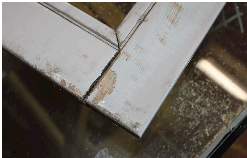
2 | Dégradation des angles à la suite d'un collage non optimal
