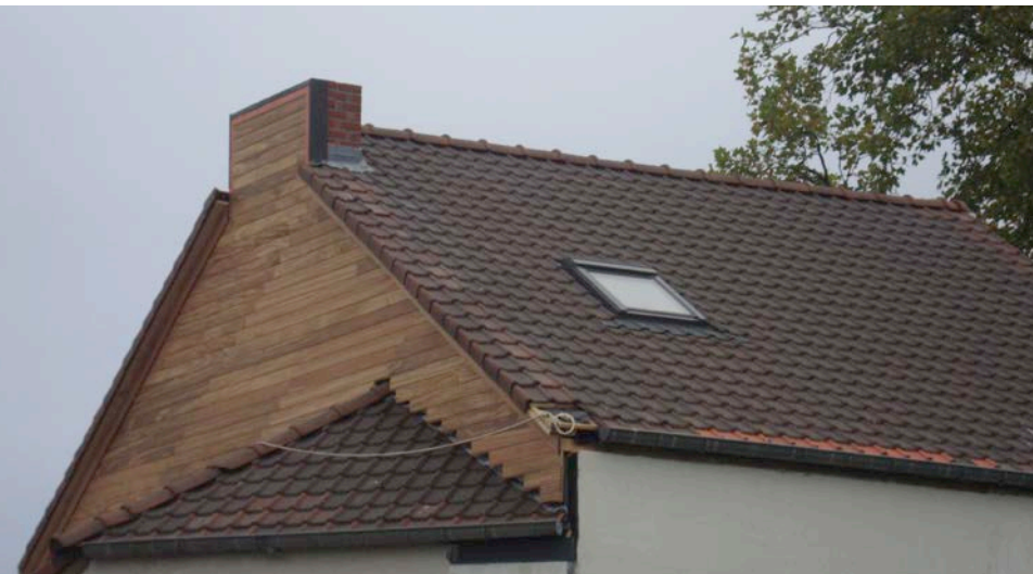
3 | Maison isolée par l'extérieur plusieurs années après réfection de la toiture. Des variations de teinte sont visibles au niveau des rives et du bas de toiture.
