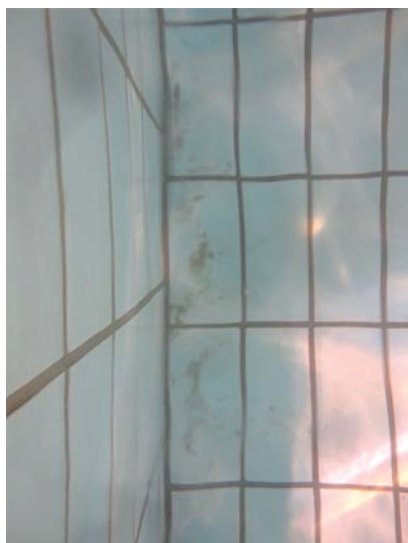
Formation de dépôts due à la dégradation des matériaux
