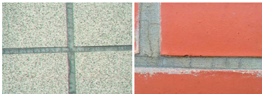
1 et 2 | Microfissures de retrait des joints d'un dallage et d'une maçonnerie
