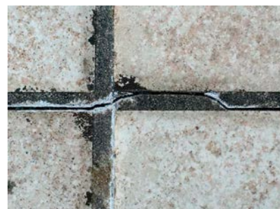
3 | Fissures générées par des dilatations hygrothermiques et/ou des mouvements du support
