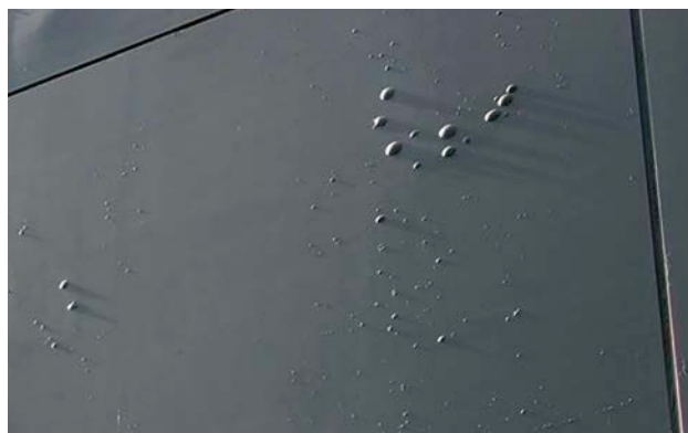
2 | Phénomène de bullage en surface d'une peinture de couleur sombre appliquée sur béton.
