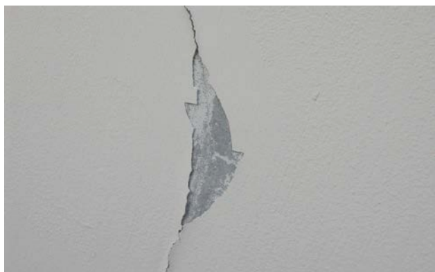
1 | Détérioration d'un revêtement alkyde sur un support en béton non carbonaté et en présence d'humidité.
