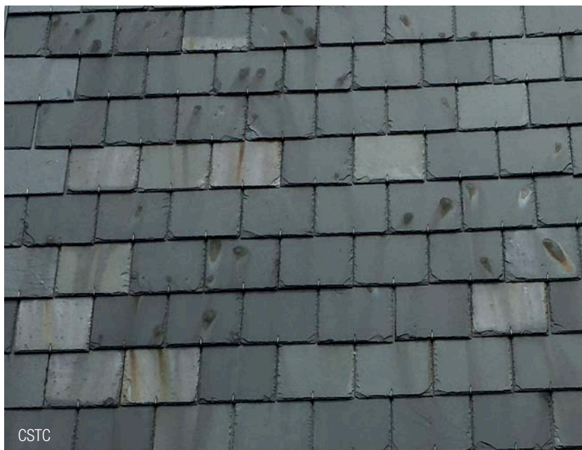
2 | Bardage constitué de deux types d'ardoises et marqué par des coulures d'oxyde de fer et le blanchiment (carbonates) de certaines ardoises.
