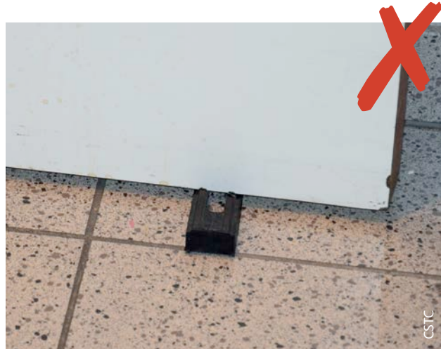
2 | La fermeture automatique de la porte a été volontairement bloquée.
