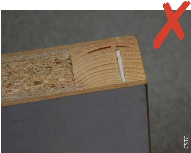
1 | La traverse supérieure du vantail et son produit intumescent ont été totalement rabotés.
