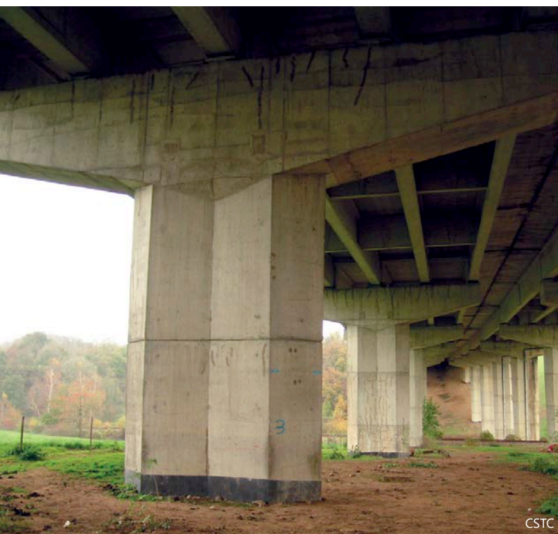
Structure en béton touchée par une réaction alcali-silice.
