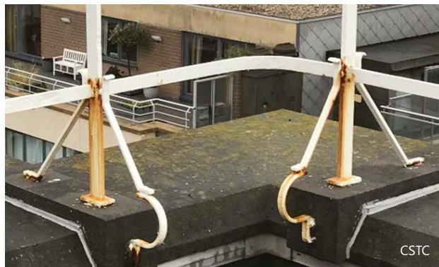
4 | Corrosion due à une contamination résiduelle en chlorures.
