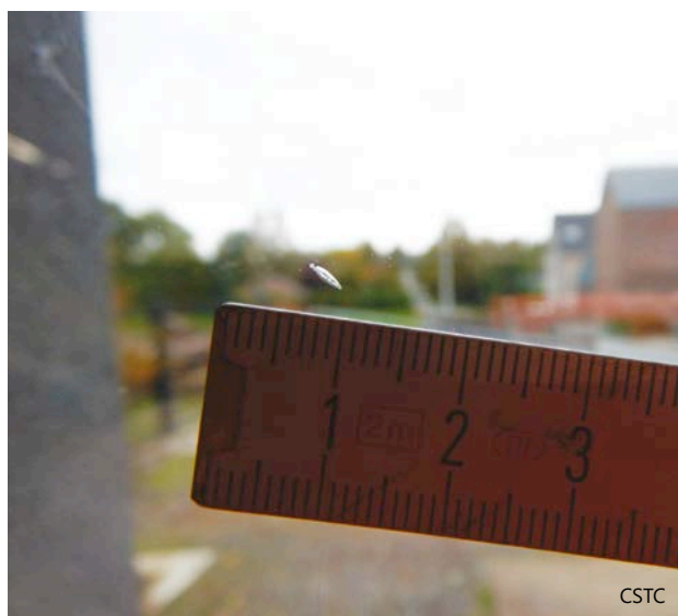
2 | Défaut linéaire (admissible).
