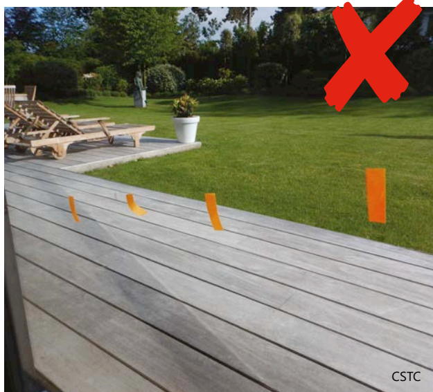
4 | Ne pas marquer les anomalies avant d'observer le vitrage.
