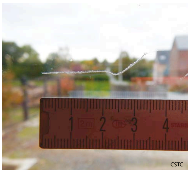
1 | Défaut linéaire (non admissible).
