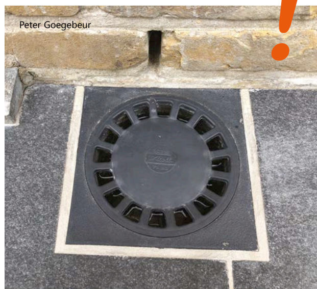
2 | Joint autour d'un avaloir (acceptable si la largeur du joint est constante et si elle n'est pas supérieure ou inférieure de plus de 2 mm à la largeur convenue).
