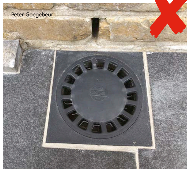
1 | Joint asymétrique autour d'un avaloir (non acceptable).
