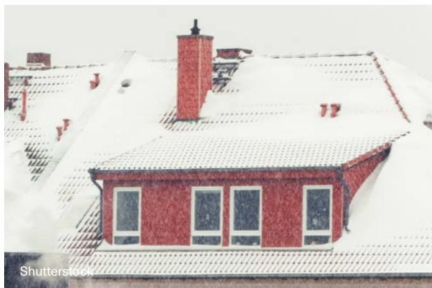
2 Accumulation de neige au pied des lucarnes.
