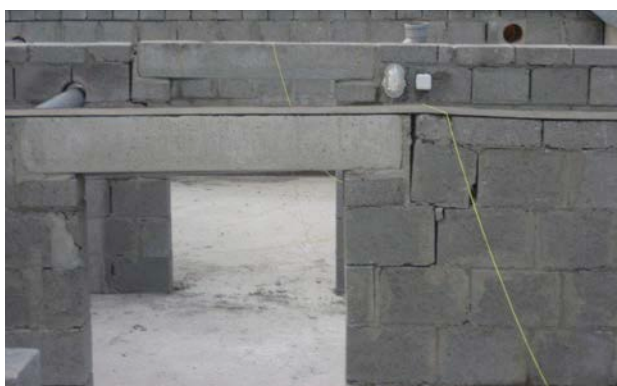
1 Dégâts occasionnés à la maçonnerie portante à la suite d'une période de gel durant la phase de construction.
