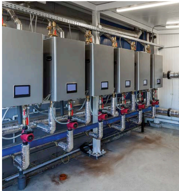
1 Chaufferie abritant plusieurs chaudières montées en cascade.
