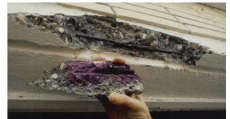
Afb. 1 Carbonatatie diepte op een vers breukvlak.
