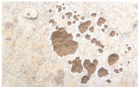
Afb. 1 Voorbeeld van vorstschade.
