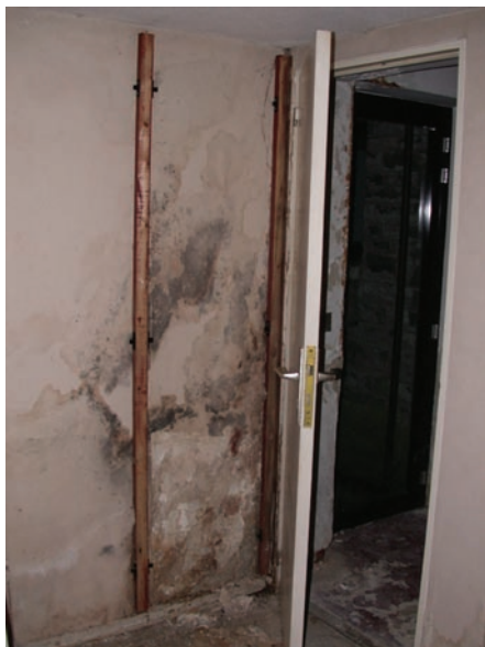
Afb. 2 Vocht en schimmelvorming ter hoogte van de afwerkingen.
