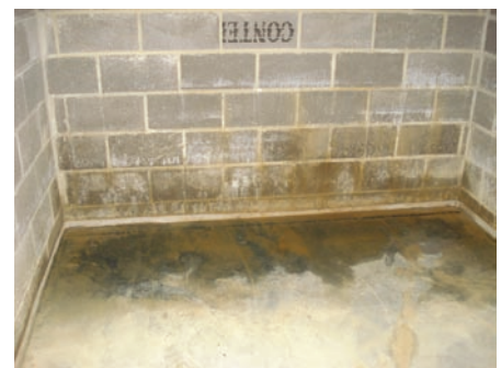
Afb. 3 Vocht aan de voet van een kelder muur.
