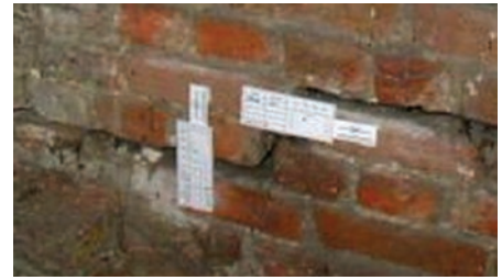
Afb. 8 Plaatsing van een nonius aan weerszijden van een scheur.
