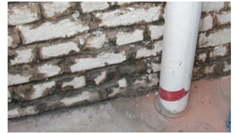
Afb. 10 Voorbeeld van uitbloeiingen en van de beschadiging van de voegen.
