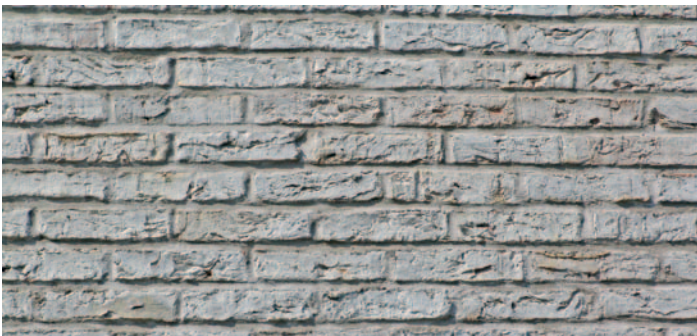
Afb. 26 Traditioneel metselwerk met onregelmatige bakstenen (onrealistisch om hier een specifieke voegdikte of dunne voegen voor te schrijven) (geval 1).
