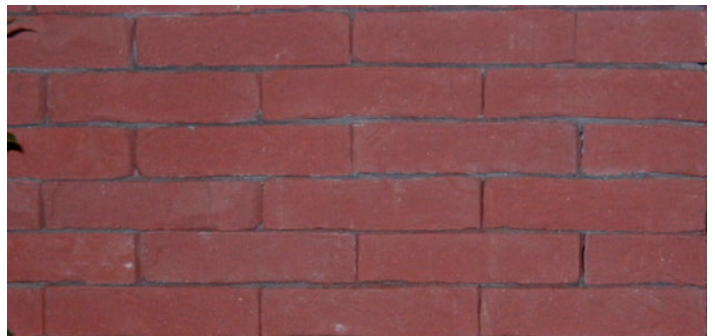
Afb. 27 Gelijmd metselwerk met dunne voegen en onregelmatige bakstenen (onrealistisch om hier een specifieke voegdikte of dunne voegen voor te schrijven).
