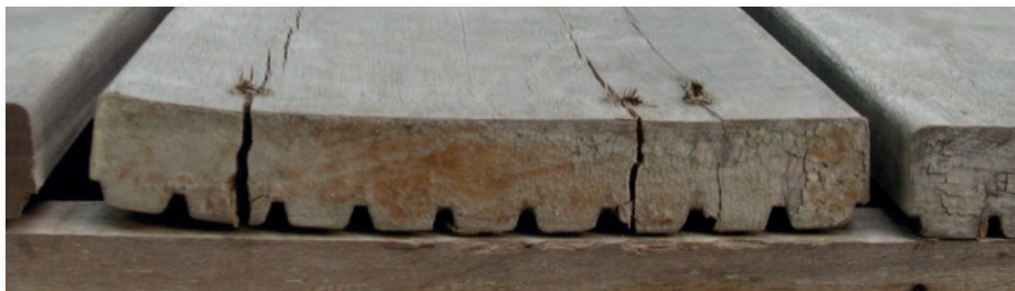
Afb. 1 Scheurvorming ter hoogte van een bevestiging
