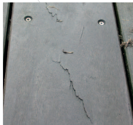
Afb. 2 Afschilfering van het houtoppervlak
