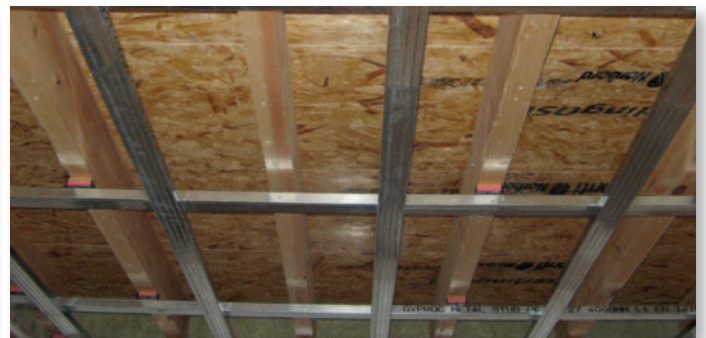
Afb. 4 Verlaagd plafond bevestigd aan een metalen regelwerk dat ontkoppeld werd van de draagvloerconstructie
