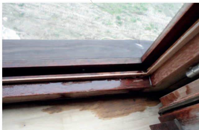
De waterdichtheid van houten vensters zonder oppervlakteafwerking is niet altijd gegarandeerd
