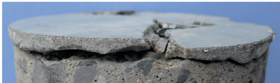
Delaminatie van het betonoppervlak
