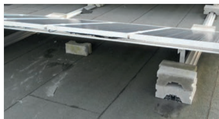
Afb. 1 Verschoven fotovoltaïsche installatie
