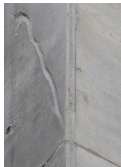
4 | Afdruk in het betonoppervlak door een losgekomen CPF-liner
