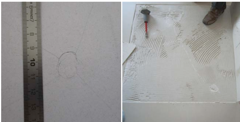
1 en 2 | Scheurvorming en ponsschade op een tegel met een zeer groot formaat en een zeer geringe dikte (links) ten gevolge van een onvoldoende verlijming (rechts)
