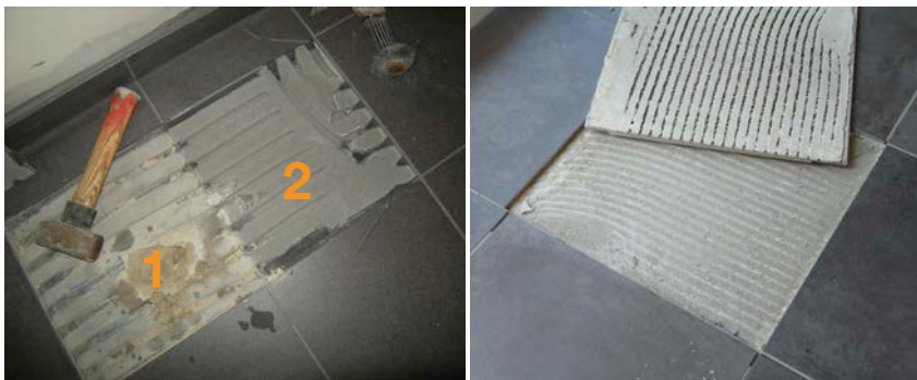
5 en 6 | Onthechting van een betegeling op een anhydrietgebonden dekvloer
