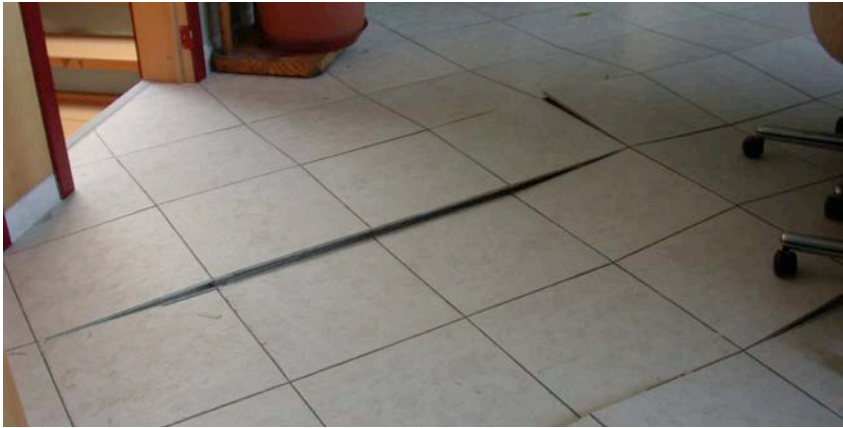
3 | Opwelling van de betegeling op een verharde dekvloer
