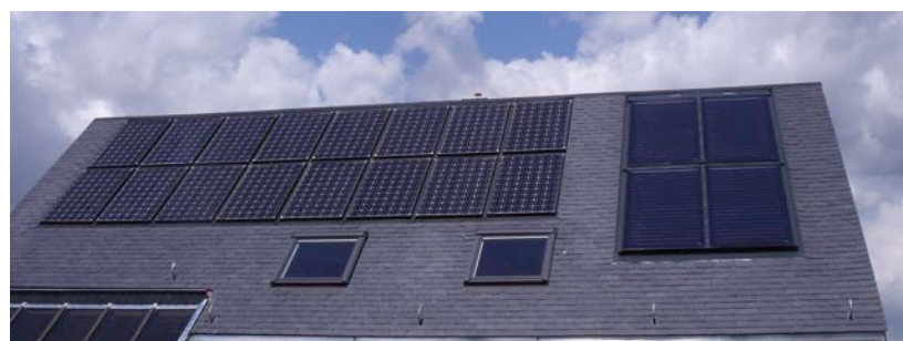
Integratie van fotovoltaïsche (links) en thermische (rechts) zonnepanelen in een hellend dak
