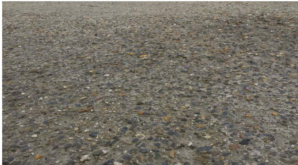
2 | Oppervlakkige afschilferingen door vorst in combinatie met dooizouten.
