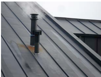
1 | Bruine vlekvorming op een dak in de buurt van het rookgasafvoerkanaal van de verwarmingsketel
