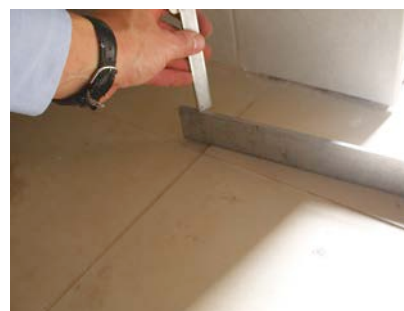
5 | Meting van het niveaunderschil tussen twee aangrenzende tegels.
