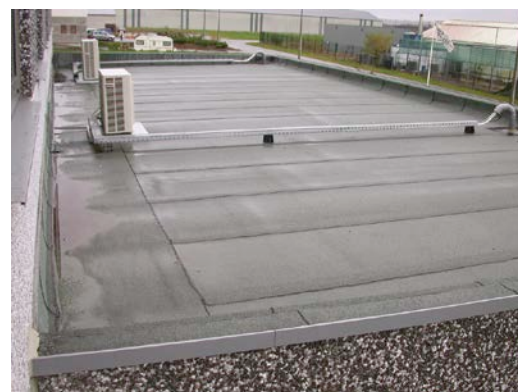
Plasvorming op een plat dak
