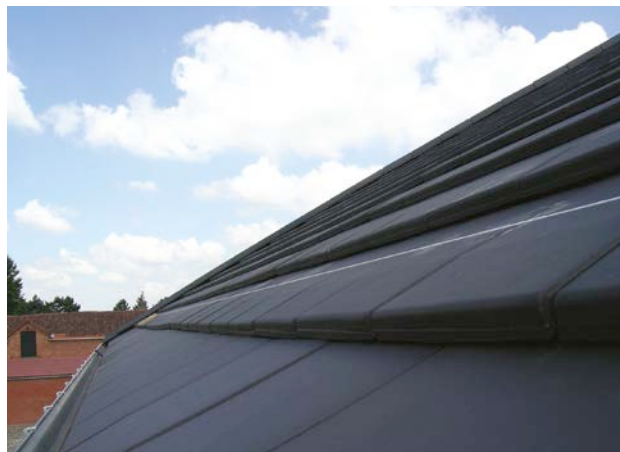
3 | Opmeting van de doorbuiging van een dakbedekking.
