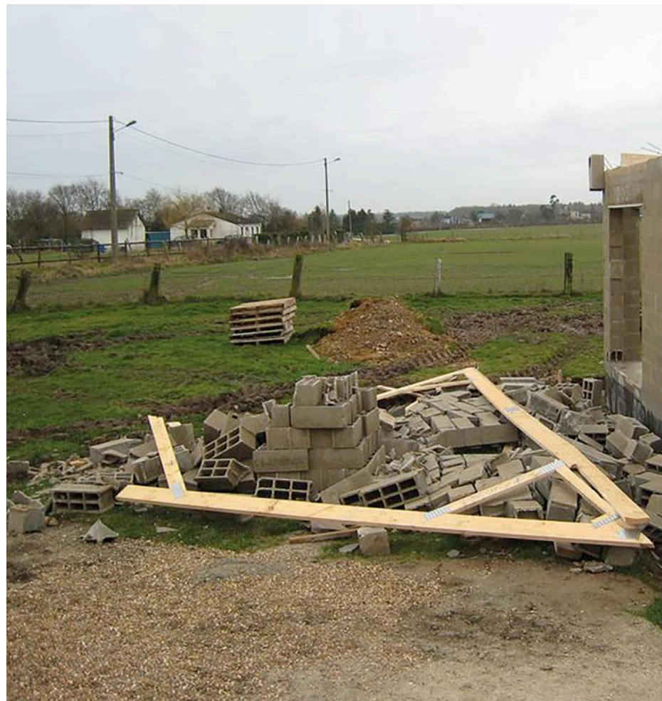
Instorting van een puntgevel uit metselwerk ten gevolge van zware windbelastingen
