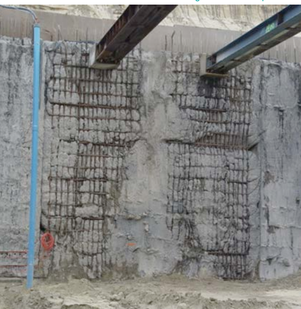
Schade vastgesteld aan diepwanden
