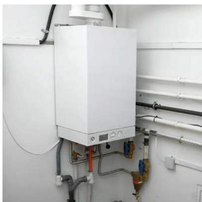
1 | Centrale warmtegenerator: ketel
