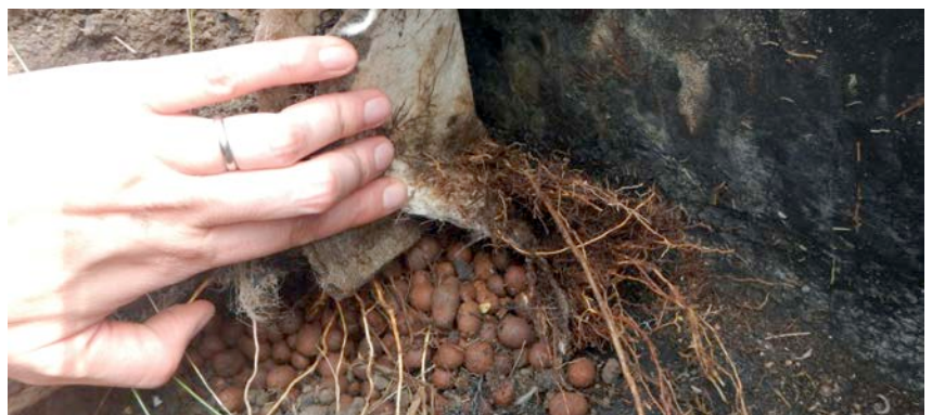
2 | Wortels die het afdichtingsmembraan van dak nr. 7 bereikt hebben
