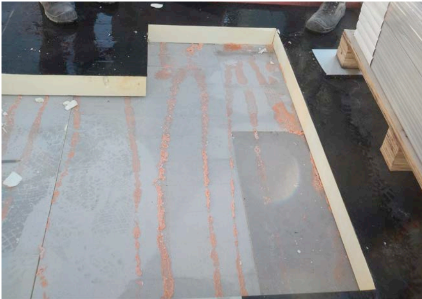
2 | De verspreiding van het vocht in het dakcomplex maakt het moeilijk om de oorsprong van de infiltraties op te sporen.
