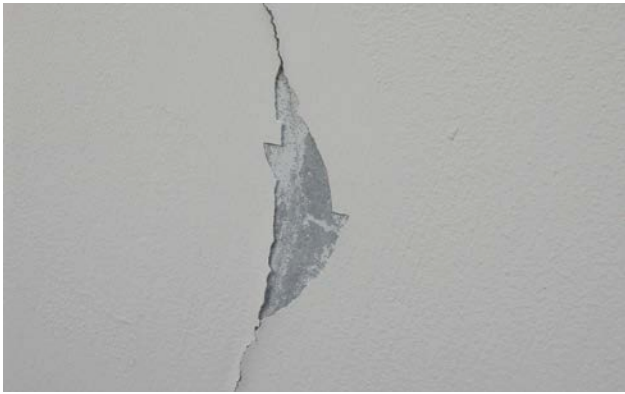
1 | Beschadiging van een alkydverf die op een niet-gecarbonateerde betonnen ondergrond en bij aanwezigheid van vocht toegepast werd.
