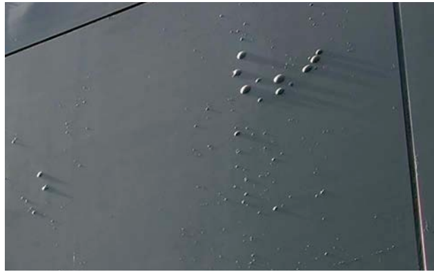
2 | Blaasvorming aan het oppervlak van een donkerkleurige verf die toegepast werd op een betonnen ondergrond.
