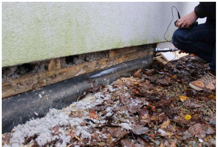
1 | Analyse van de beschadigingen aan de muurvoet.
