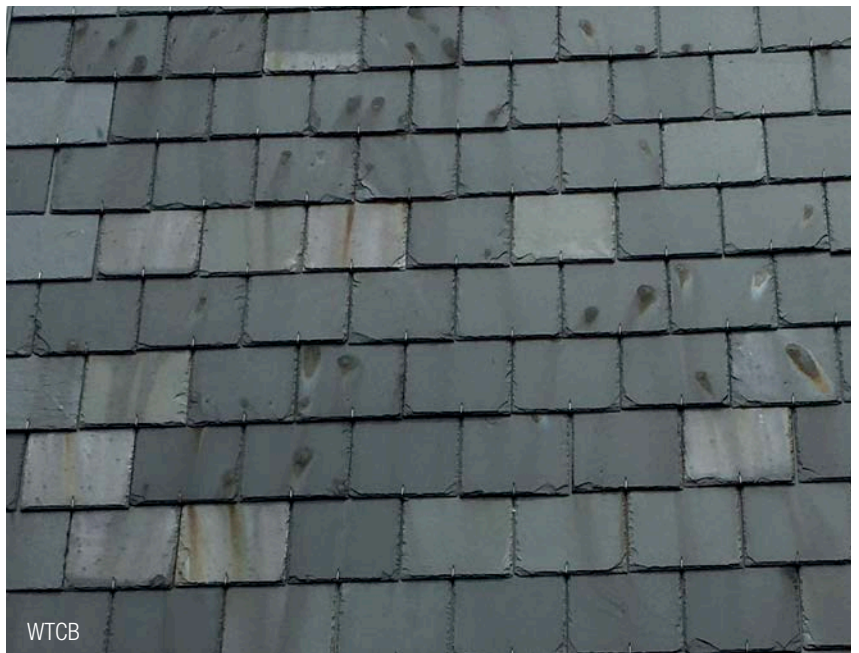
2 | Gevelbekleding die opgebouwd is uit twee leisoorten waarin op bepaalde leien ijzeroxidelopers en witachtige verkleuringen (carbonaten) zichtbaar zijn.
